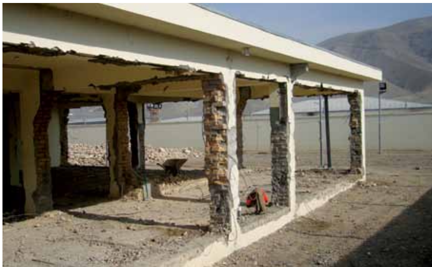
ساختمان 17 ، یکی از سه ساختار به شدت آسیب دیده در محبس بغلان، به دلیل مشکلات ایمنی تخریب شد. به راپور تفتیش IP-62-14 مراجعه کنید. (عکس INL)
