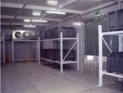
تاسیسات ذخیره گاه گرشک شامل تجهیزات قفسه بندی و سرمای می باشد. به راپور تفتیش 82-IP-14 مراجعه کنید. (عکس RC-SW)
